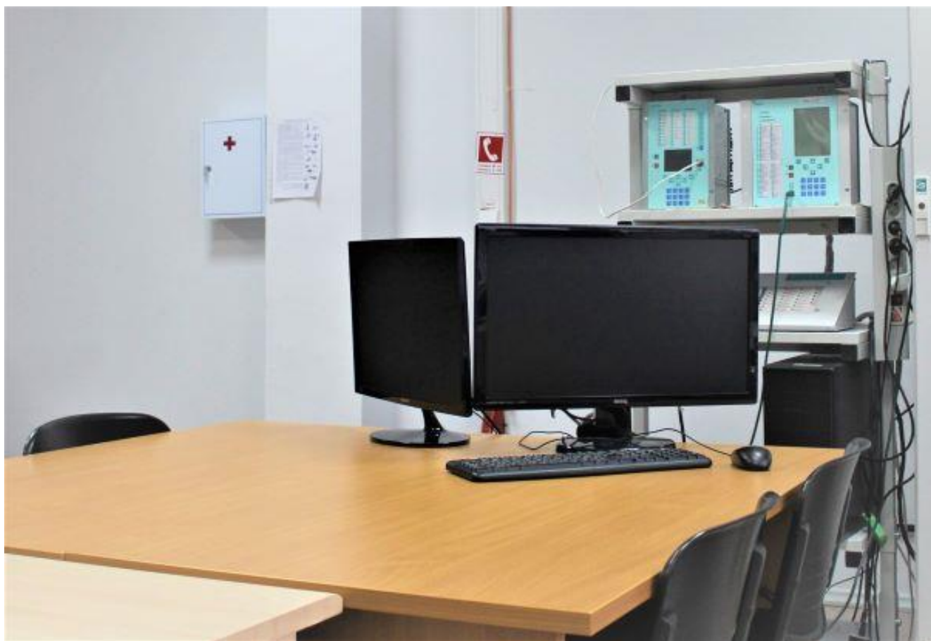
Рис. 10 Лабораторный комплекс устройств РЗА энергообъектов напряжением 6-35 кВ
