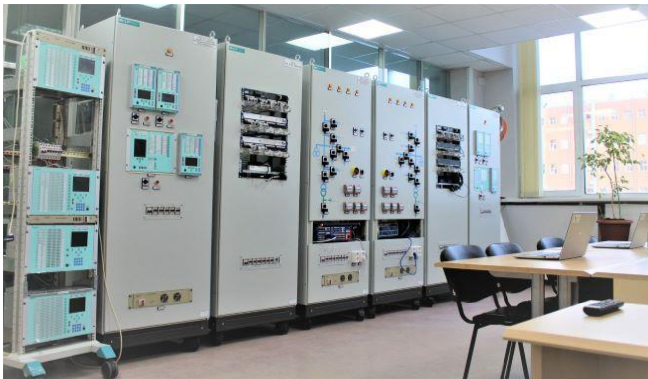
Рис. 14 Лабораторный комплекс «Высокоавтоматизированная подстанция»
