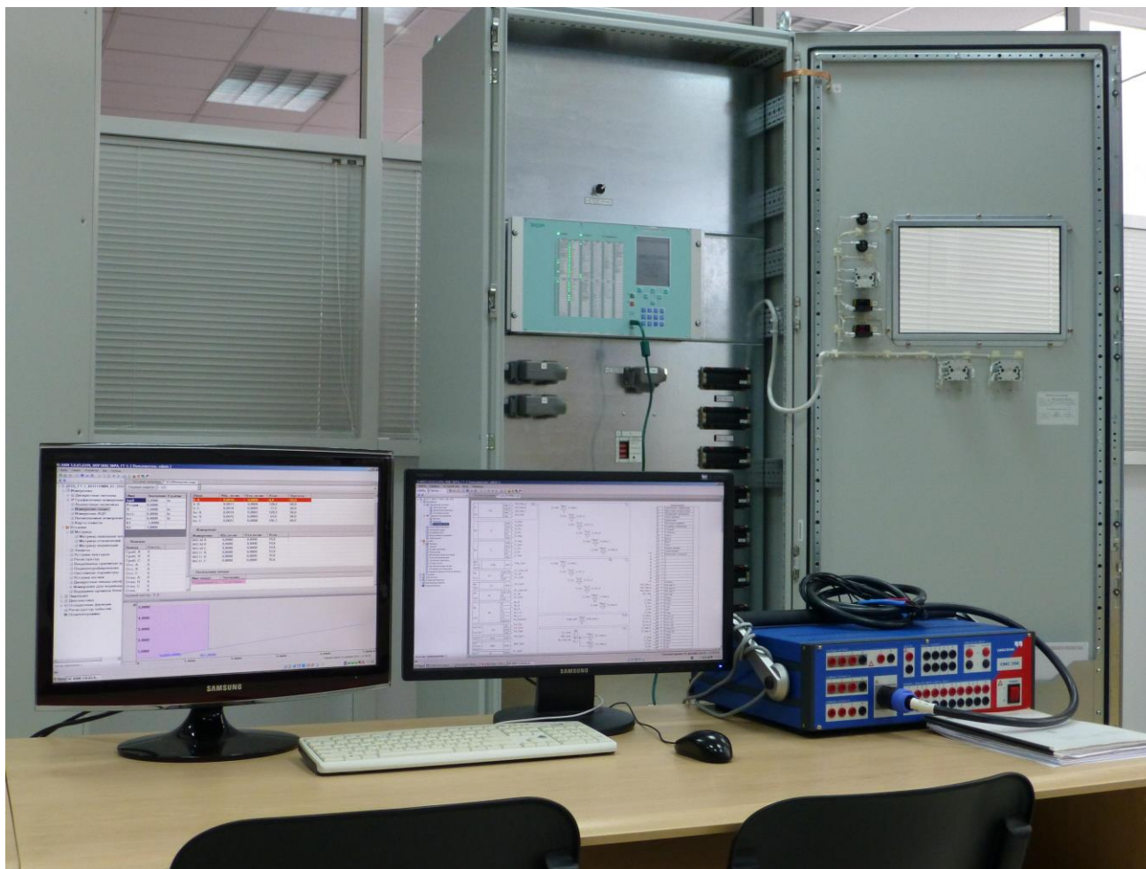
Рис. 9 Лабораторный комплекс на основе шкафа ШЭ1111
