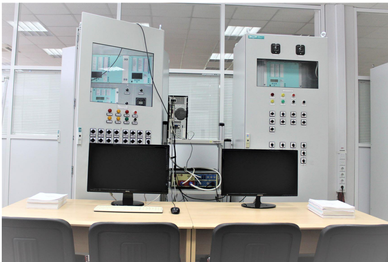
Рис. 6 Лабораторный комплекс на основе шкафа ШЭ2607 152
