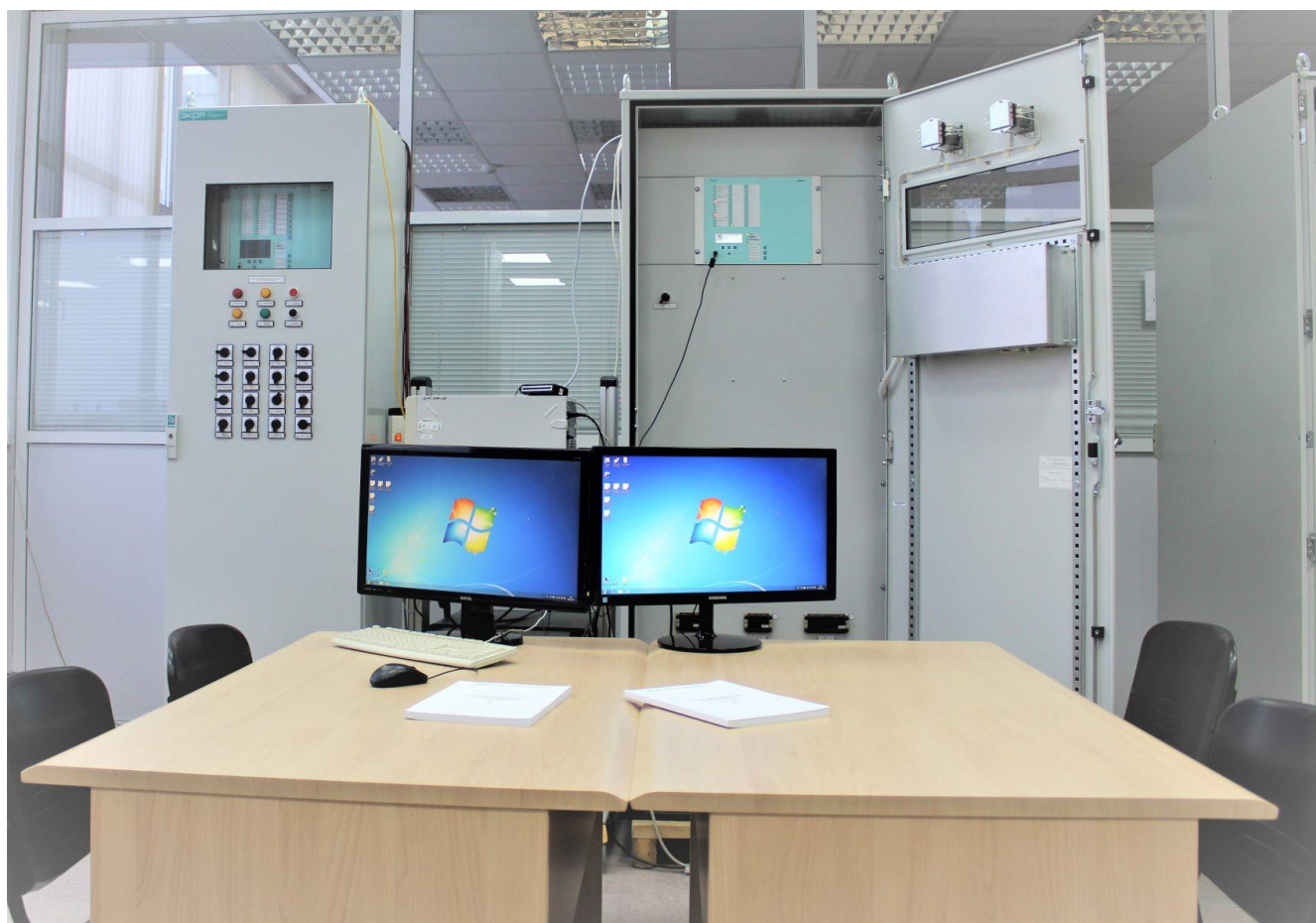
Рис. 7 Лабораторный комплекс на основе шкафа ШЭ2710 511
